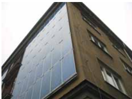
Obrázek 2: Fotovoltaický systém na fasádě na budově TUL v Liberci. Foto: EkoWATT
