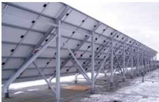
Obrázek 5: Nosná konstrukce FVE na ZČU, kde konstrukce prochází hydroizolační vrstvou. Zdroj: Solartec s. r. o.
