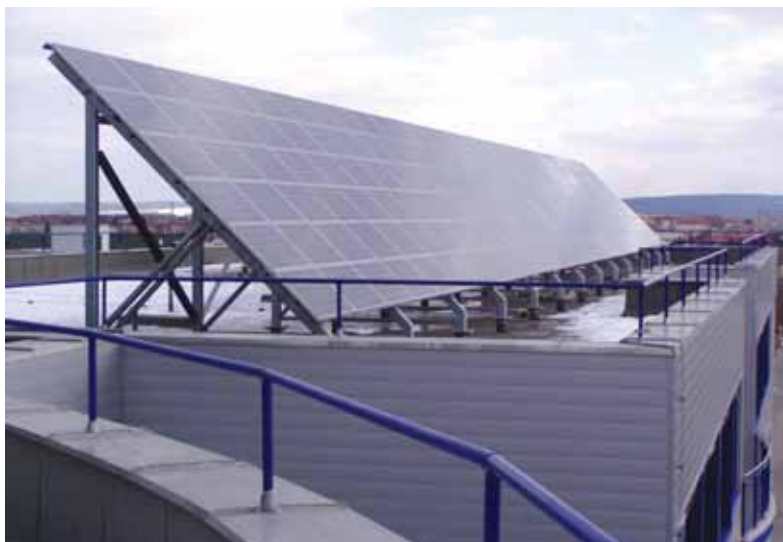
Obrázek 43: Fotovoltaický systém na budově ZČU v Plzni. Zdroj: Solartec s. r. o.
