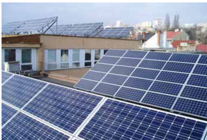
Obrázek 45: Fotovoltaický systém na budově UJEP v Ústí nad Labem. Zdroj: Solartec s. r. o.
