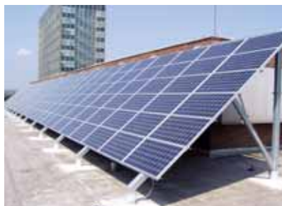
Obrázek 4: Panely na střeše MFF UK, kde kotvení konstrukce prochází hydroizolační vrstvou. Zdroj: Solartec s. r. o.
